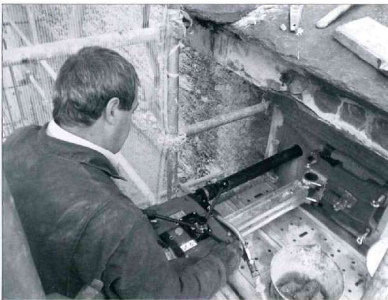
Sur le chantier de la chapelle de la Miséricorde à Breil : ci-dessus, carottage pour la pose de tirants de consolidation de la façade ; à droite, réfection de la toiture. Photo Entreprise DEGIOANNI
